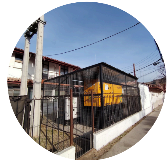
SUBESTACION ELECTRICA Y GRUPO ELÉCTROGENO
